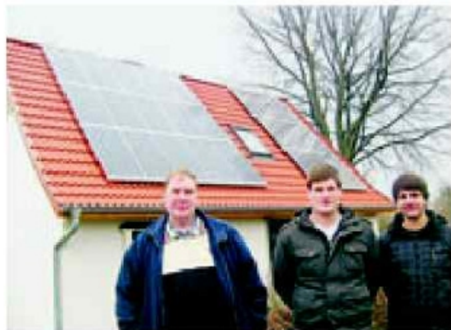
Bastian Lübke- mann (v. rechts) und Dennis Scheper haben mit Holger Laudeley auf eigene Rechnung Solaranlagen installiert. GRU-FOTOS: GRU
